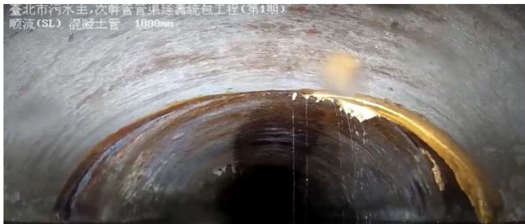
建國南路1段 42450116-424 距離:50.56m 速度:0.04M/S 破損龜裂、滲漏水 (12~3點鐘方向)
