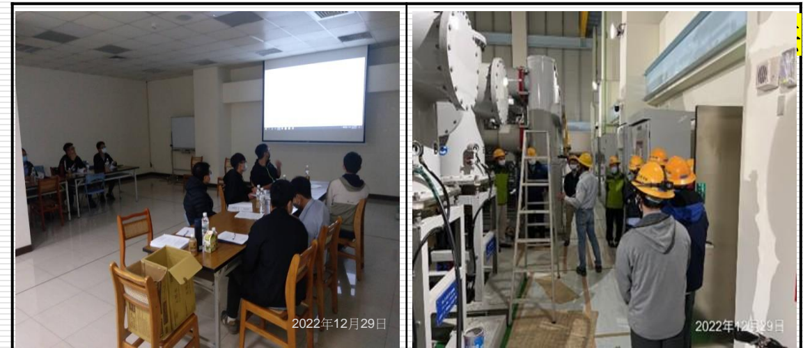
161kV GIS開關設備講解
