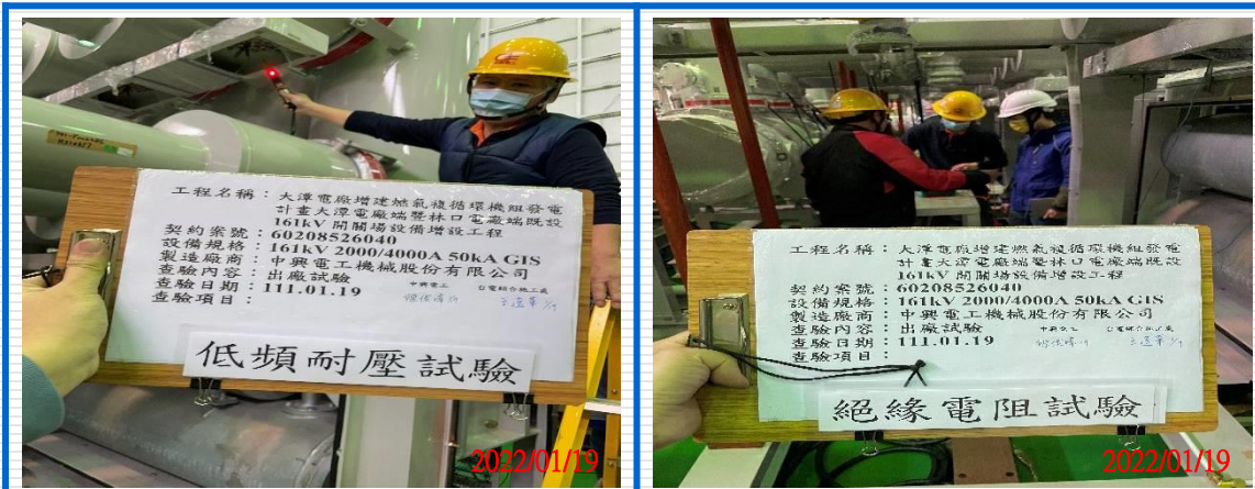
GIS設備廠驗(低頻耐壓試驗及絕緣電阻試驗)
