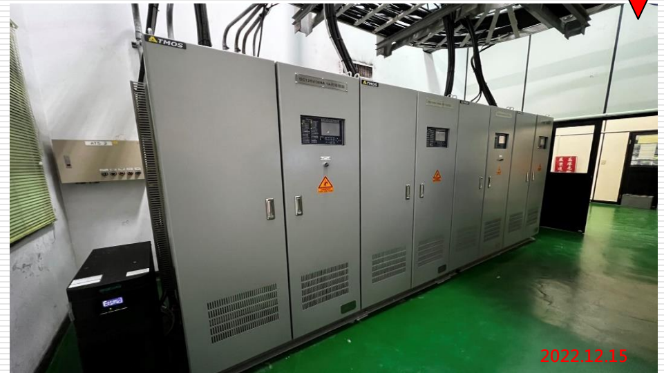
新設直流充電機
