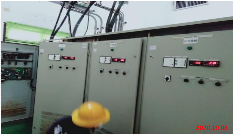
既有直流充電機
