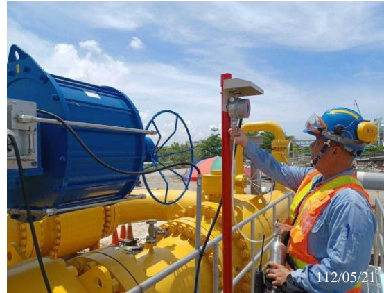
瓦斯偵測器洩漏測試(A)
