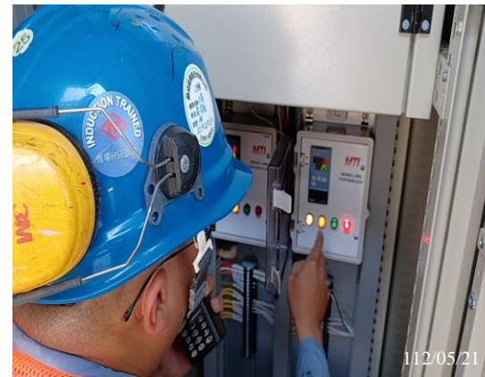
瓦斯偵測洩漏主機測試(B)
