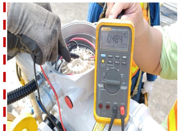
MOV電動閥電壓測試(2)
