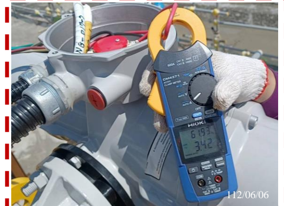
MOV電動閥電流測試(1)
