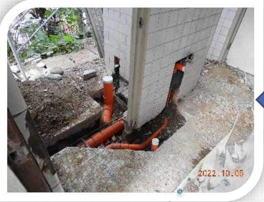
天主教圖書館廁所配管
