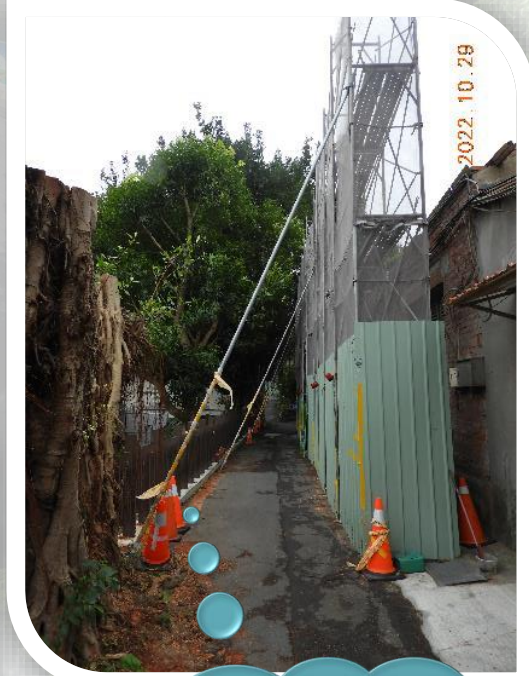
施工鷹架無法使用避 拉桿，採用斜支撐加 強穩定安全及警示帶 交通錐維護行走安全
