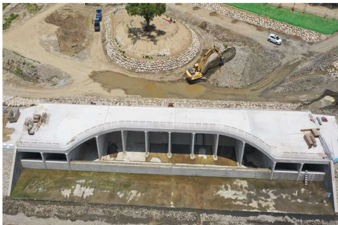
入流設施-溢流堰
