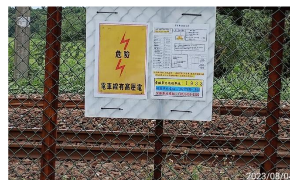
臨軌側感電標示及張貼緊急通報電話
